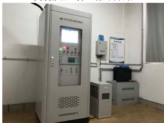
锅炉烟气在线监测设备
