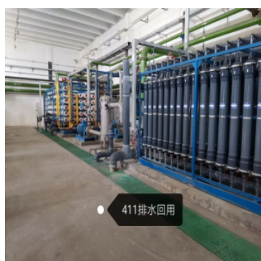
回用系统超滤装置
